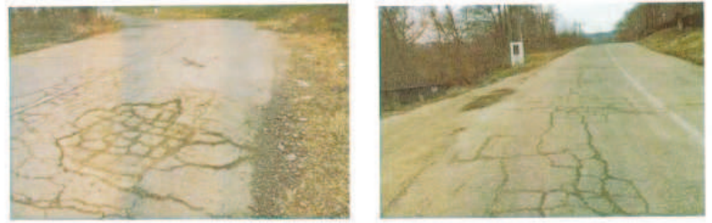
Elementele de siguranță a circulației sunt degradate sau lipsesc pe majoritatea traseului.
